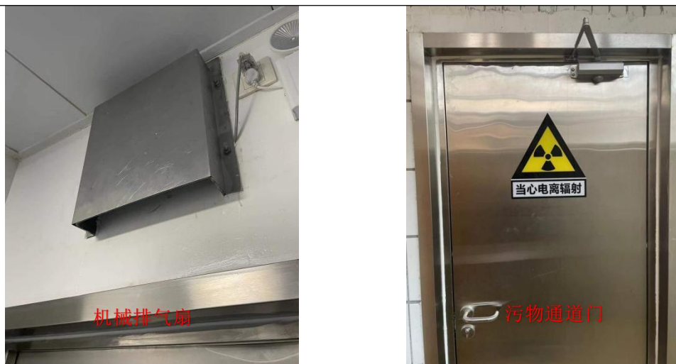
图 3-1 安全防护设施现场照片
